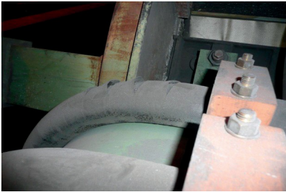
Bild 6.15 Ablagerungen auf dem Stromkabel und beschädigtes Stromkabel
