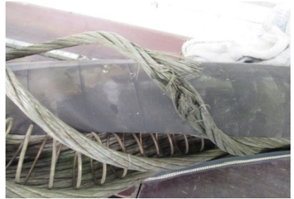
Bild 6.16 Beschädigte Kupferlitze im wassergekühlten Stromkabel
